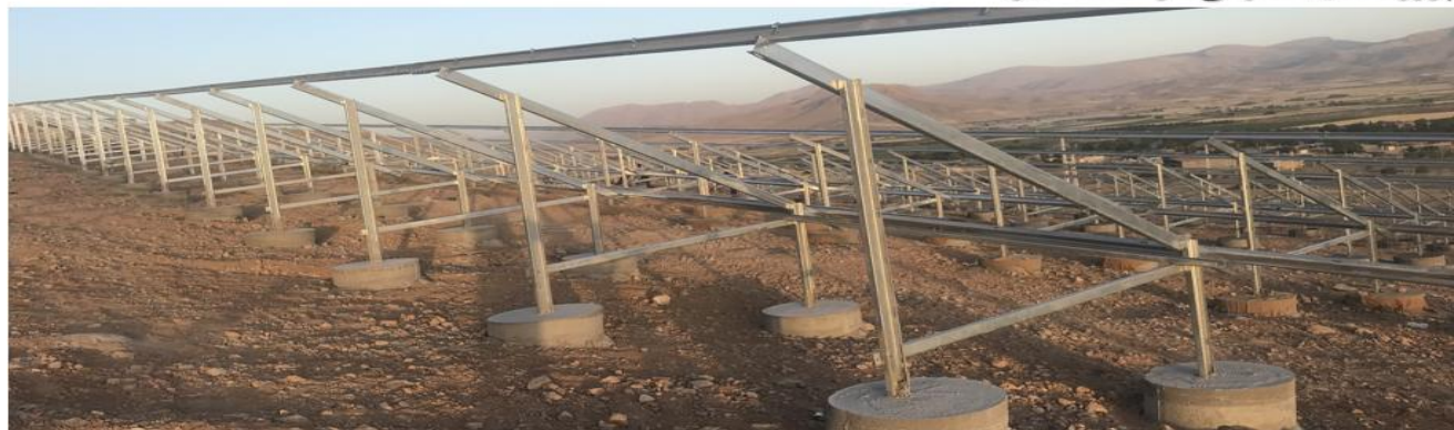
نیروگاه خورشیدی ۱.۵ مگاواتی کرمانشاه با نصب بسیار منحصر بفرد در دامنه کوه
